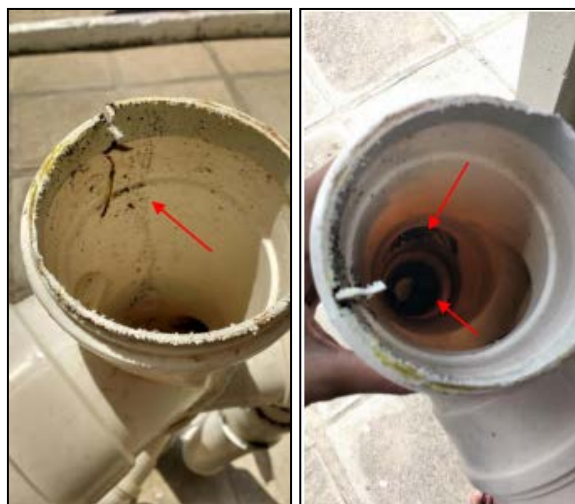
Figura 9 – Acúmulo de sujeira na tubulação de coleta de água de chuva.
